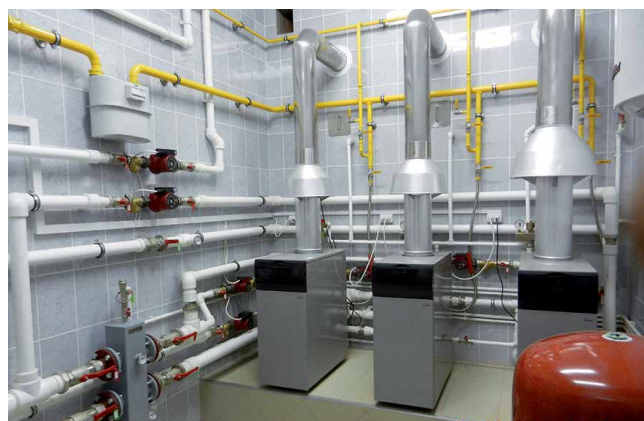
Магазин, г. Ковров Общая мощность котельной — 150 кВт
