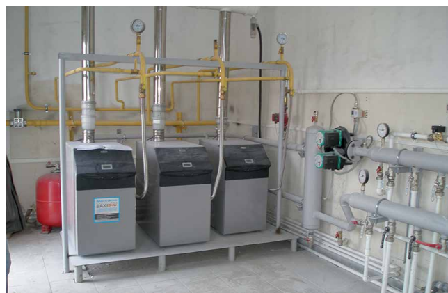
Здание рынка, д. Баранцево Общая мощность котельной — 265 кВт
