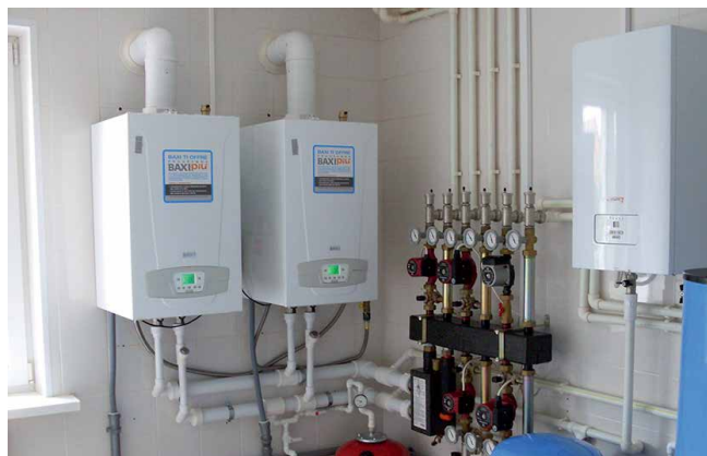
Жилой дом, г. Челябинск Общая мощность котельной — 140 кВт
