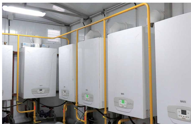
Картонно-рубероидный завод, г. Рязань Общая мощность котельной — 1,8 МВт
