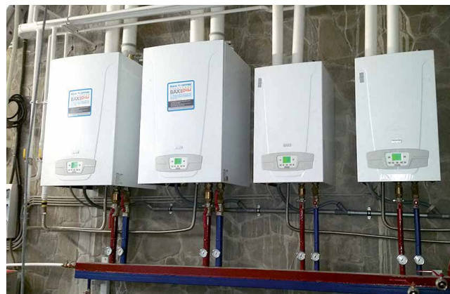
Жилой дом, г. Ставрополь Общая мощность котельной — 300 кВт
